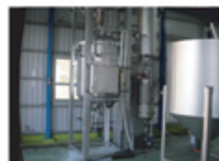
大幸産業 沖縄市 400ℓ真空脱水プラント
