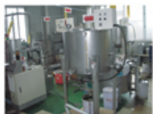
クリーン筑紫野 福岡県筑紫野市 α-50BR 200ℓ精製タンク2基
