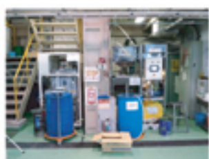
八王子市役所 戸吹清掃事業所 FA-100 減圧蒸留機α-50BR
