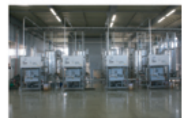
アドバン (前田建設工業) 埼玉県熊谷市 減圧蒸留装置 α-200BR 4基
